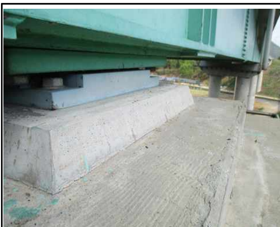
하행선 P2-SH4 무수축물탈 균열
