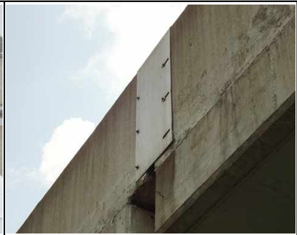
상행선 A2 차수관 볼트 탈락
