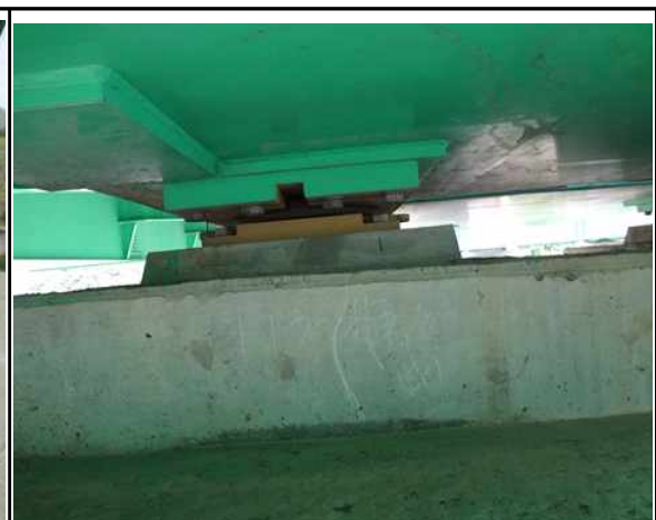
하행선 P3-SH3 받침콘크리트 균열
